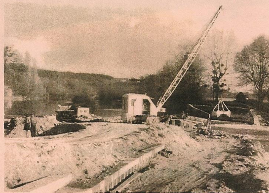
Après 5 ans d'affrontements entre un Comité de Salubrité et les autorités locales qui voulaient combler ce canal, la digue fut reconstruite en 1960.
